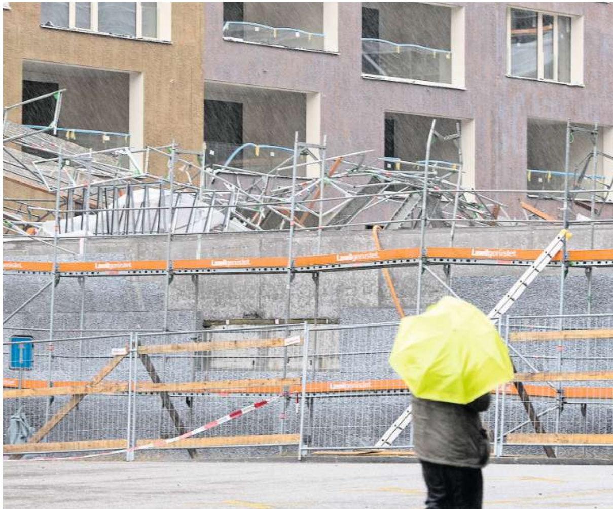
Ein umgestürztes Baugerüst in Littau (LU) nach dem Wintersturm «Burglind». (3.1.2018)
